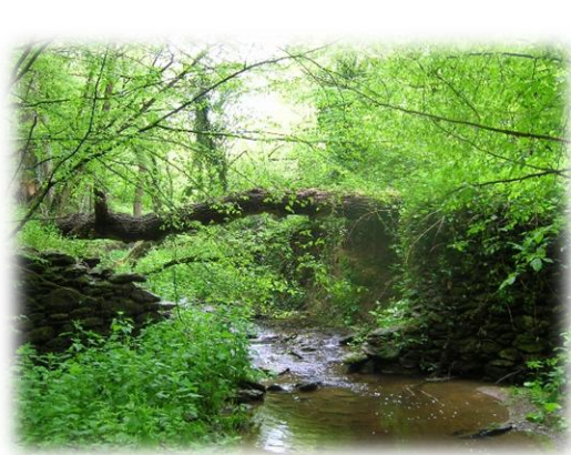
Un barrage abîmé en dessous du Coin
